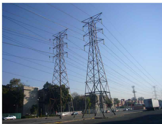
Torre de electricidad
